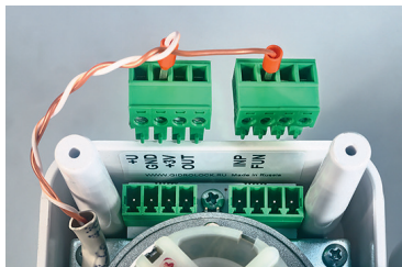
Фото 23. Подключение проводного выключателя
